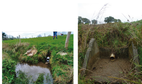
Figure 2. Photos de deux sorties de collecteurs de drains
