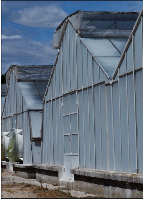
Figure 3. Installation de filets insect-proof sur les ouvrants d'aération des serres-verre.
