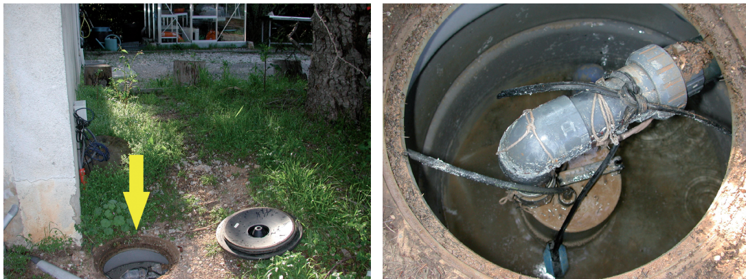
Figure 3. Cuve extérieure de rétention d'eau (photos : G. Clabots).
