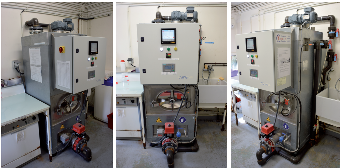
Figure 4. Cuve de traitement des eaux usées (vues de gauche, de face et de droite) (photos : G. Clabots).
