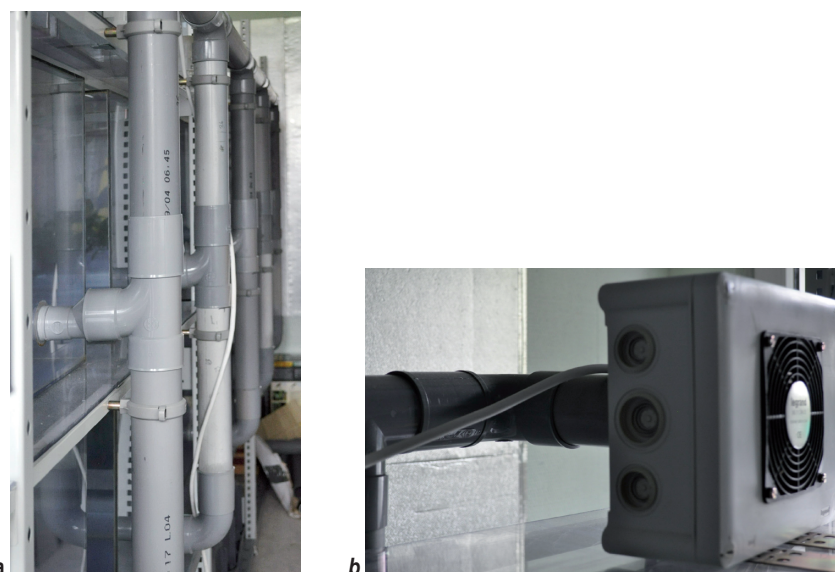
Figure 3. Système de ventilation des cages d'élevage de pucerons. a) dispositif de conduits situé à l'arrière des cages ; b) ventilateur pour armoire électrique, réalisé par notre technicien à l'INRA de Colmar, inséré dans un boîtier de dérivation L 24 cm x H 20 cm Legrand (photos M.A. Dome).
